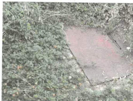
Pohľad na vodomernú šachtu
